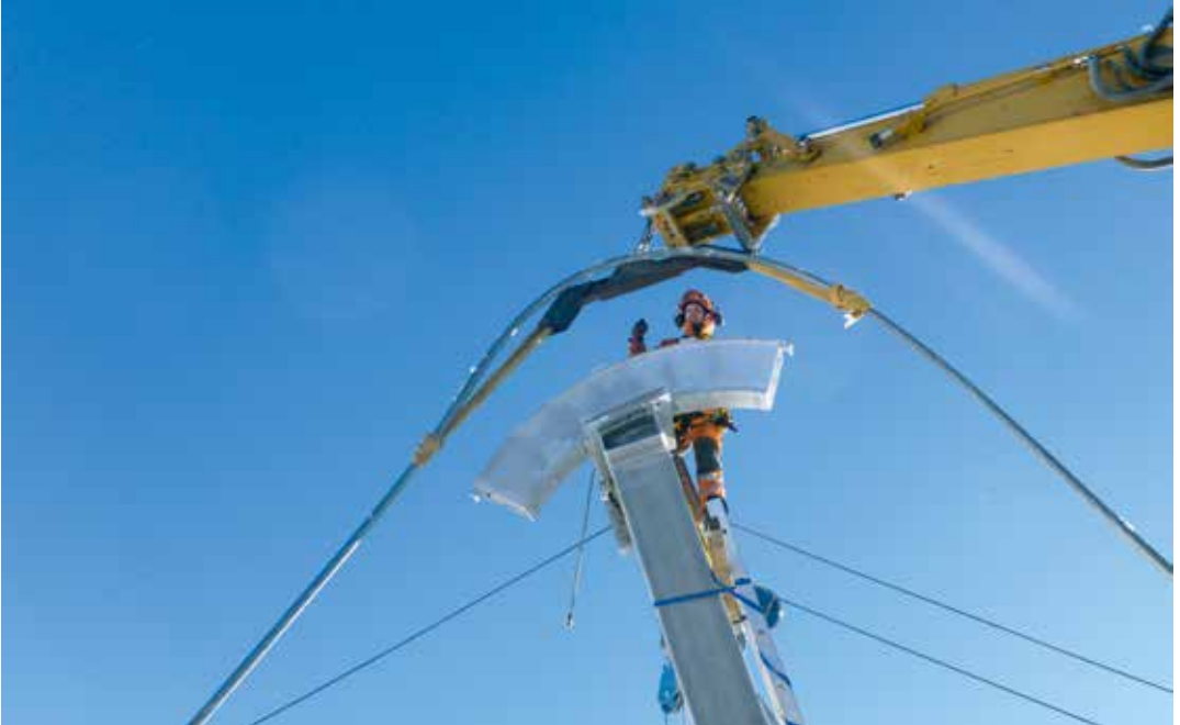
Das Tragseil wird auf den Seilsattel des Pylons, Seite Bergstation „Ice-Flyer“, aufgelegt.
